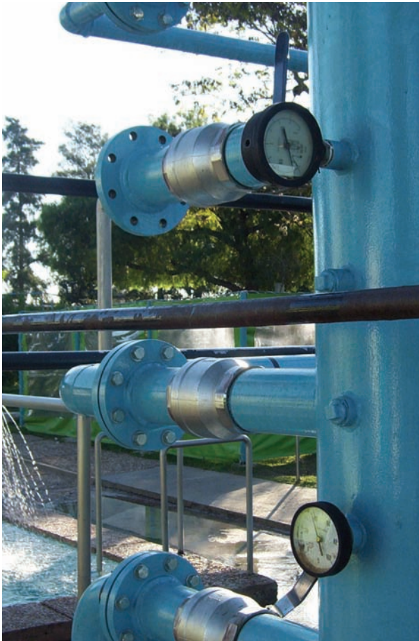
Vista de los controles de temperatura, presión y caudal del pozo termal de Guaviyú. Foto cortesía del Dr. Montaño.
